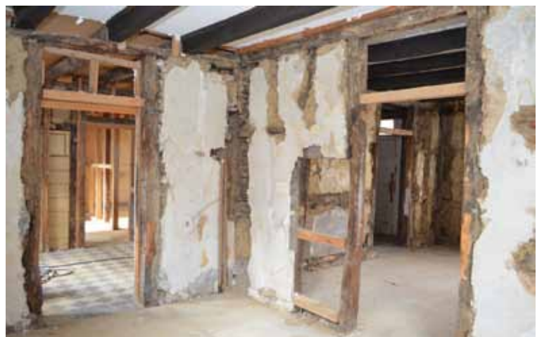
Bilder aus dem Inneren des Hauses zeigen den sanierungsbedürftigen Zustand und lassen das Ausmaß der anfallenden Arbeiten erahnen.
